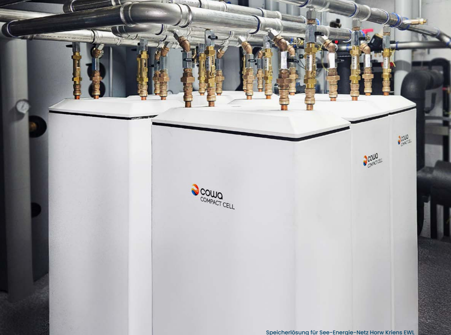
Speicherlösung für See-Energie-Netz Horw Kriens EWL
